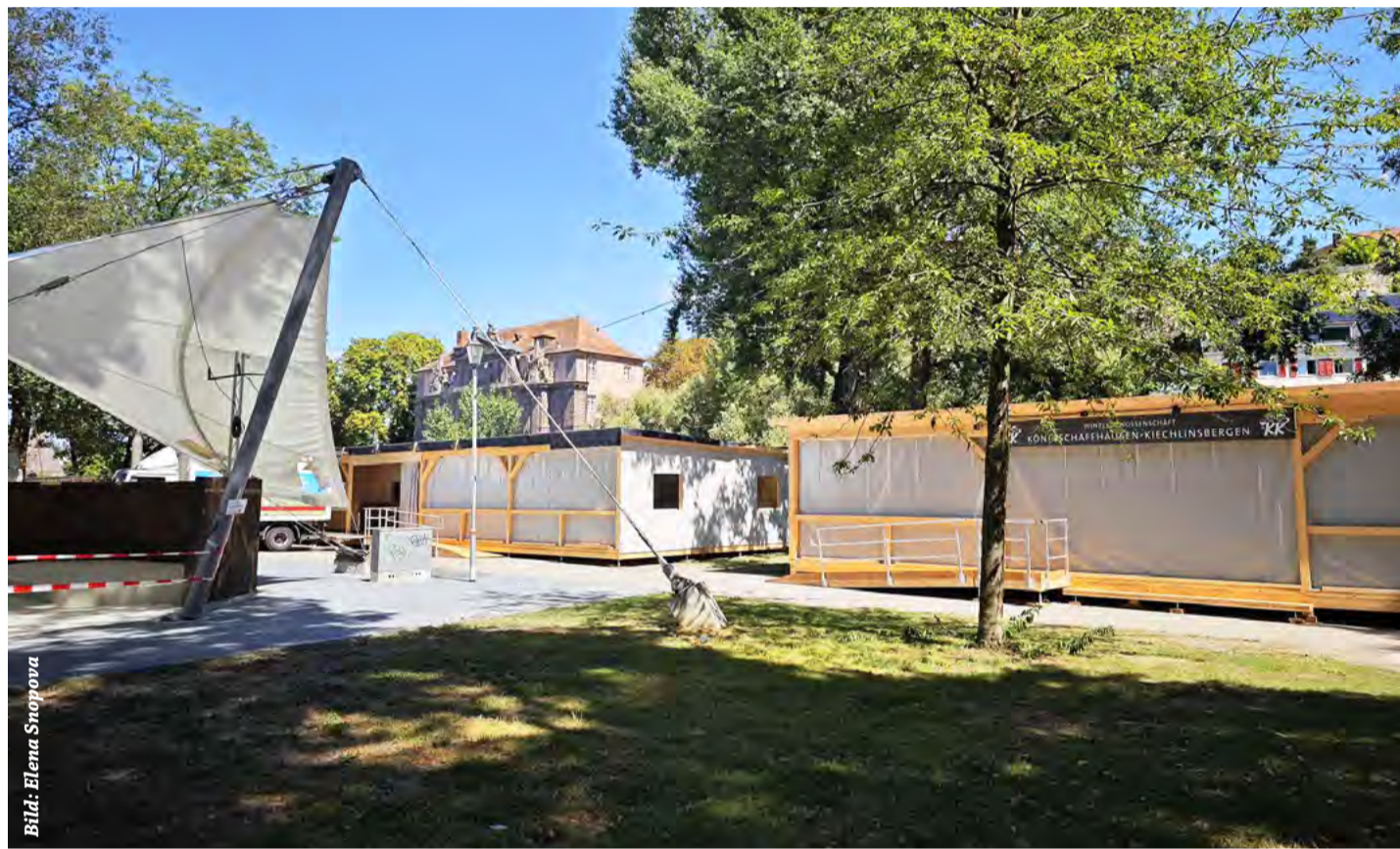
Neue Lauben für das Breisacher Weinfest sind in den vergangenen Wochen montiert worden - ein Gewinn für die Besucher aus Nah und Fern
