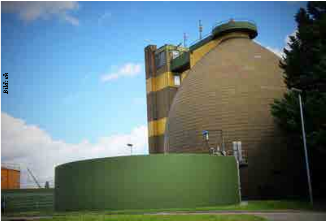
Für die Erneuerung der Schlammfaulungsinstallation müssen 2021 in Breisach 3,5 Millionen und 2022 375.000 Euro in den Haushalt eingestellt werden
