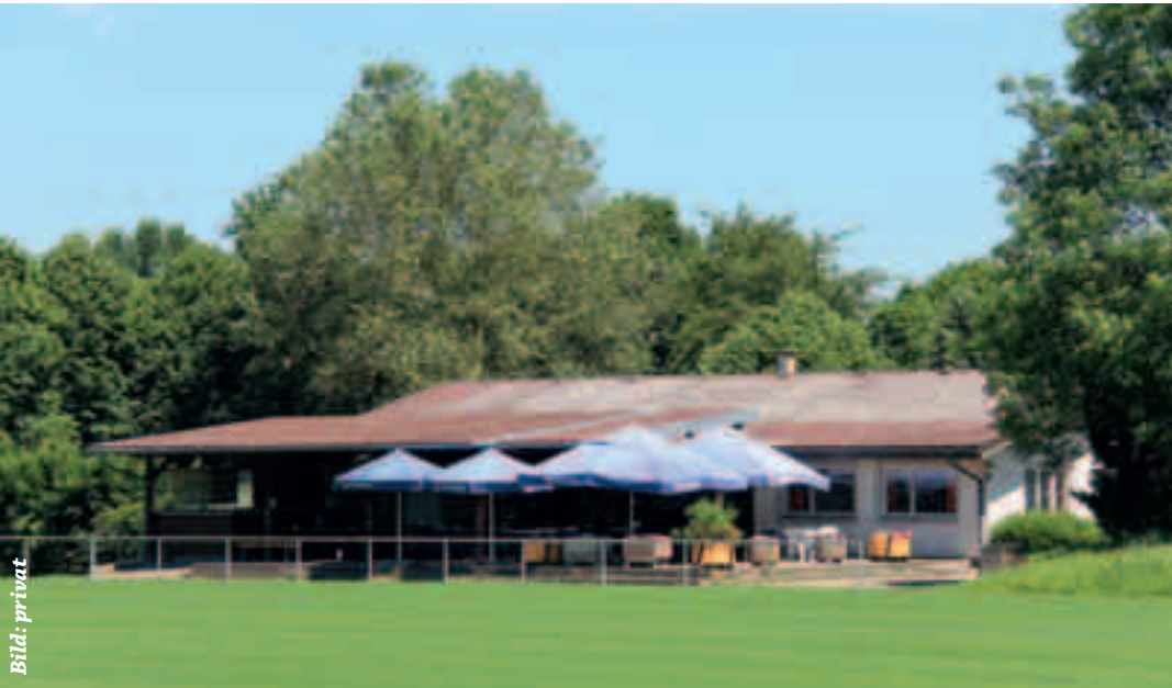
Das Clubheimdach in Wasenweiler muss dringend saniert werden
