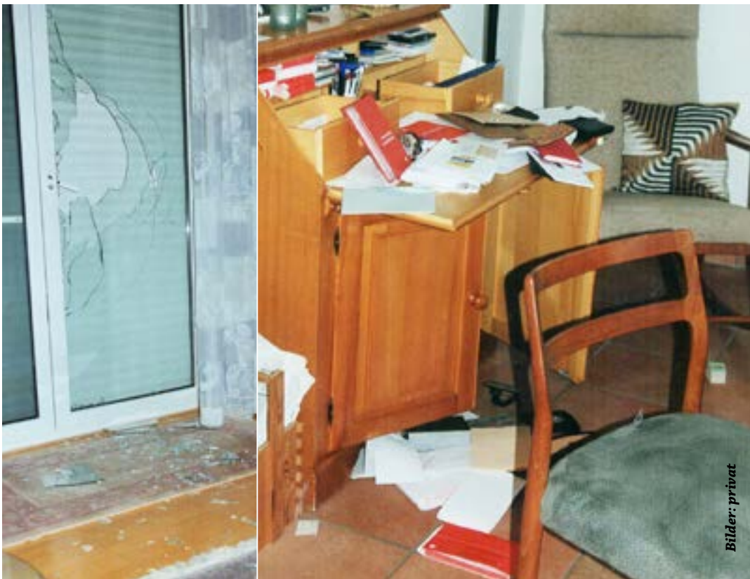
Ungebetener Besuch – so sah es nach einem Einbruch in ein Breisacher Einfamilienhaus aus
